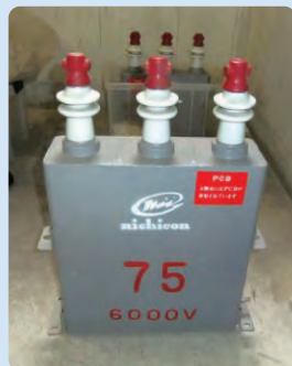
電力用コンデンサー
